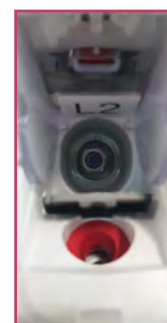
Acceso al embarrado Access to the busbar
